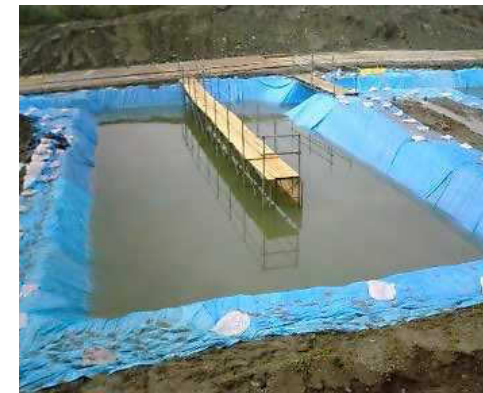
＜仮設塩素混和池＞
