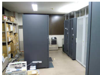
写真：コンピュータサーバ室
