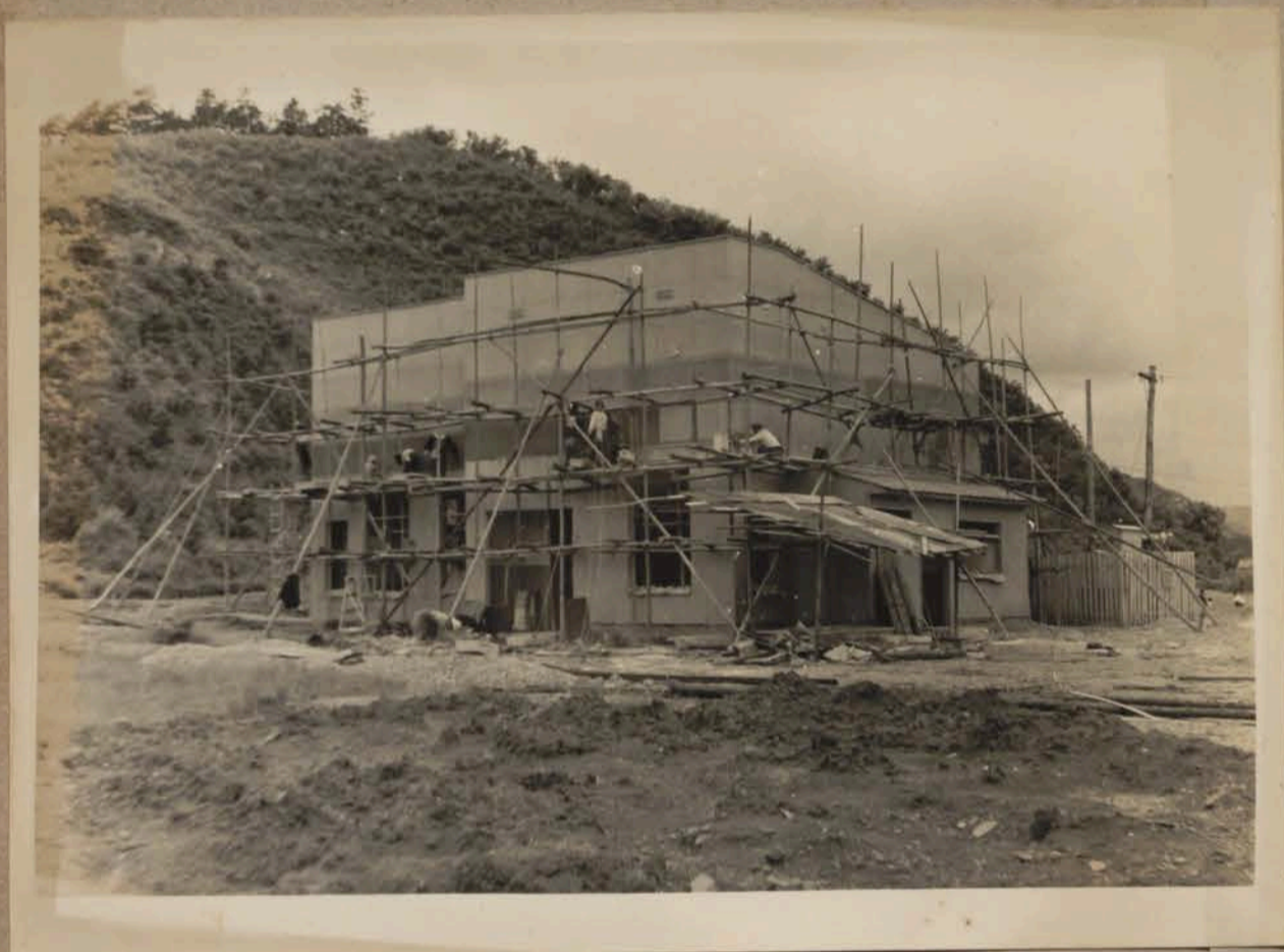
鹿沼市水道ポンプ室
