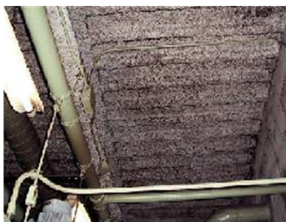
石綿含有吹付けロックウール
