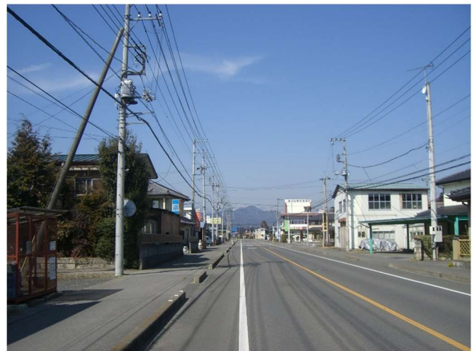
LED 防犯灯を設置した主要道路
