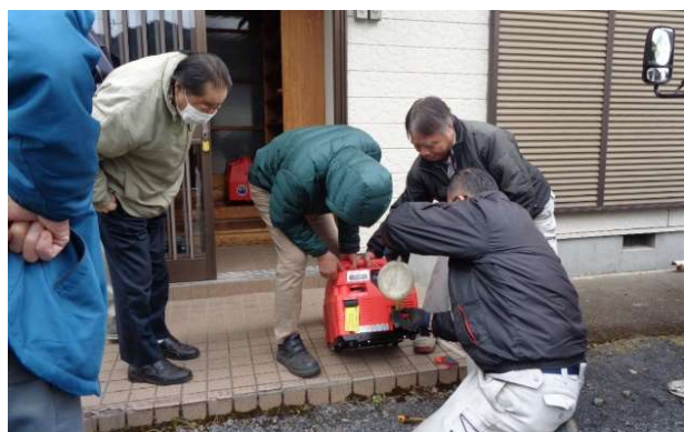
LPガス発電機の点検→
