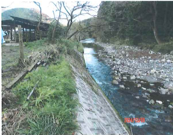
堆積砂利の様子と堤防の現状
