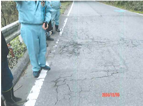
陥没が進んでいる様子
