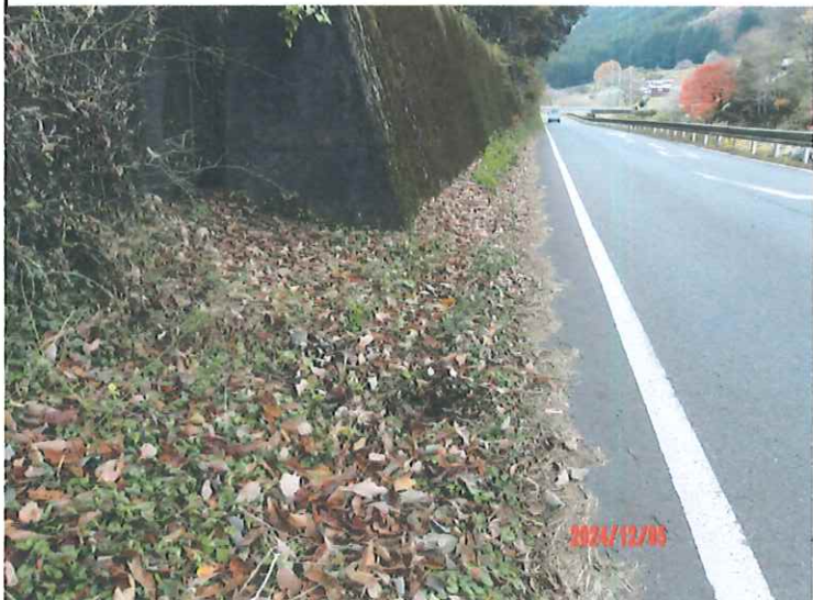
山側擁壁下部に落ち葉が堆積
