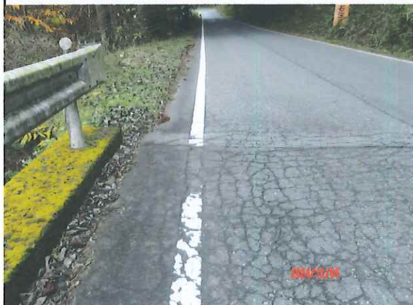
橋上部のアスファルトだけヒビが多い
