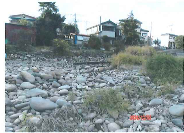
崩れた護岸・堤防
