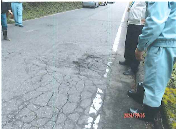
陥没が徐々に進んでいる
