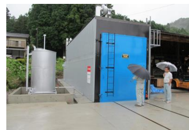
補助金を利用した人工乾燥施設の整備状況 (上永野地内)
